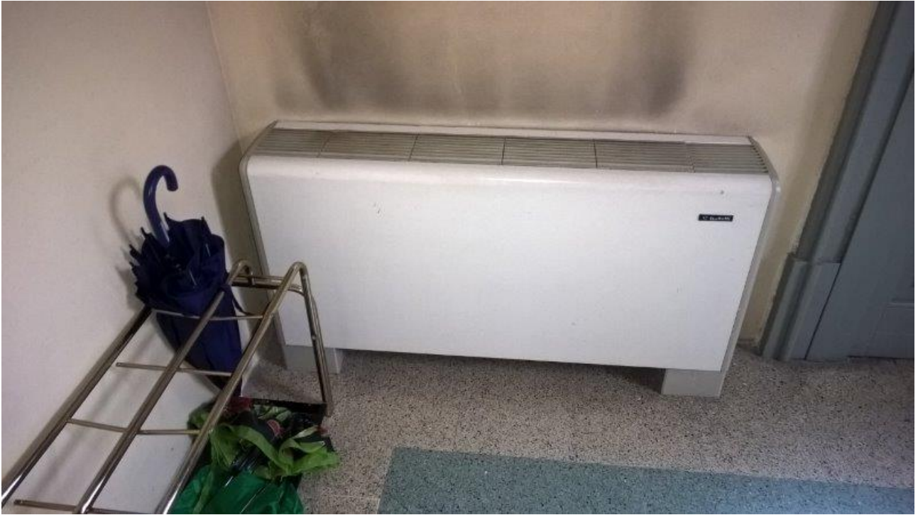
Figura 5 – Ventilconvettori zona ingresso
