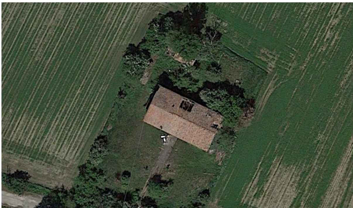
Il fabbricato interno alla Cassa. Anche in questo caso il tetto è sfondato.
