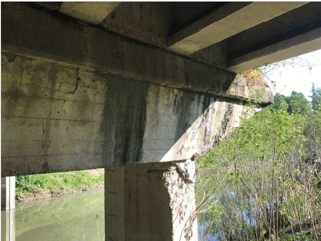
Foto 8 – Dettaglio del degrado della trave pulvino e del pilastro
