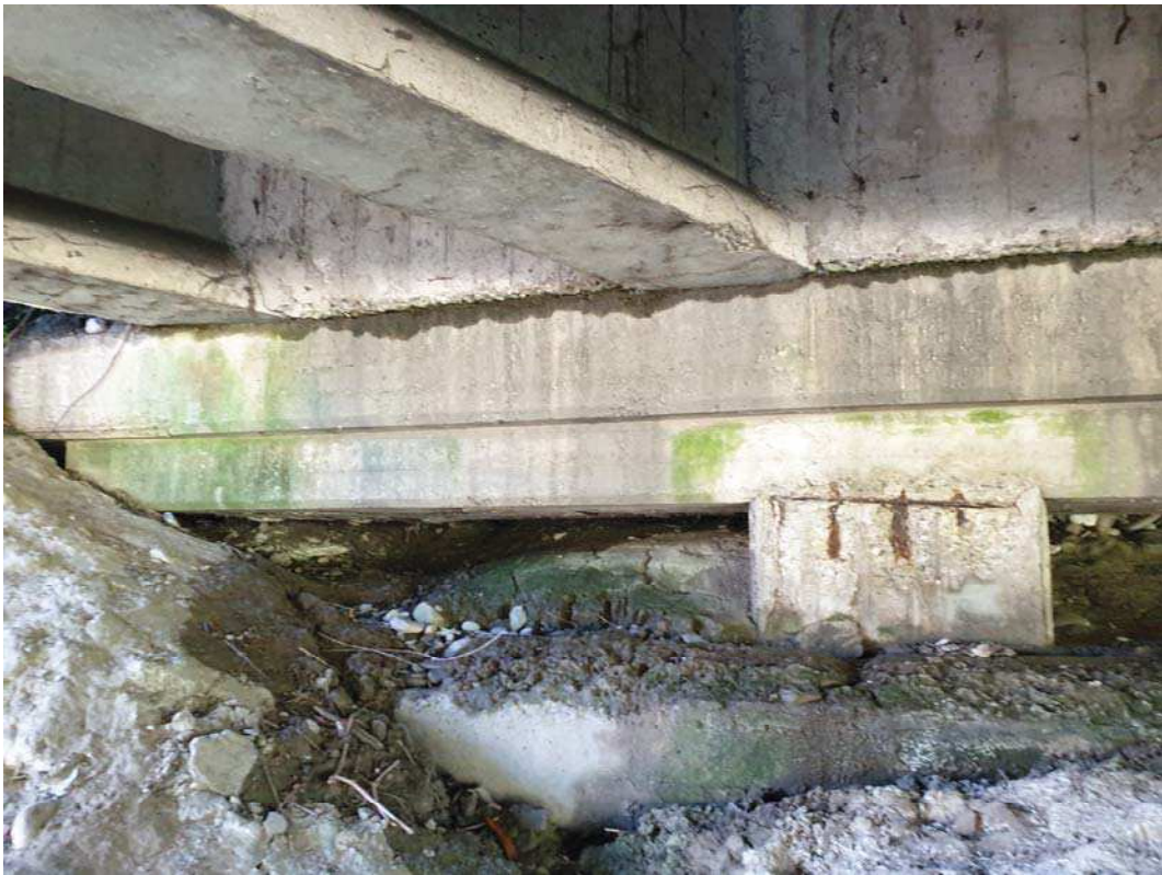
Foto 9 – Dettaglio del degrado della spalla
