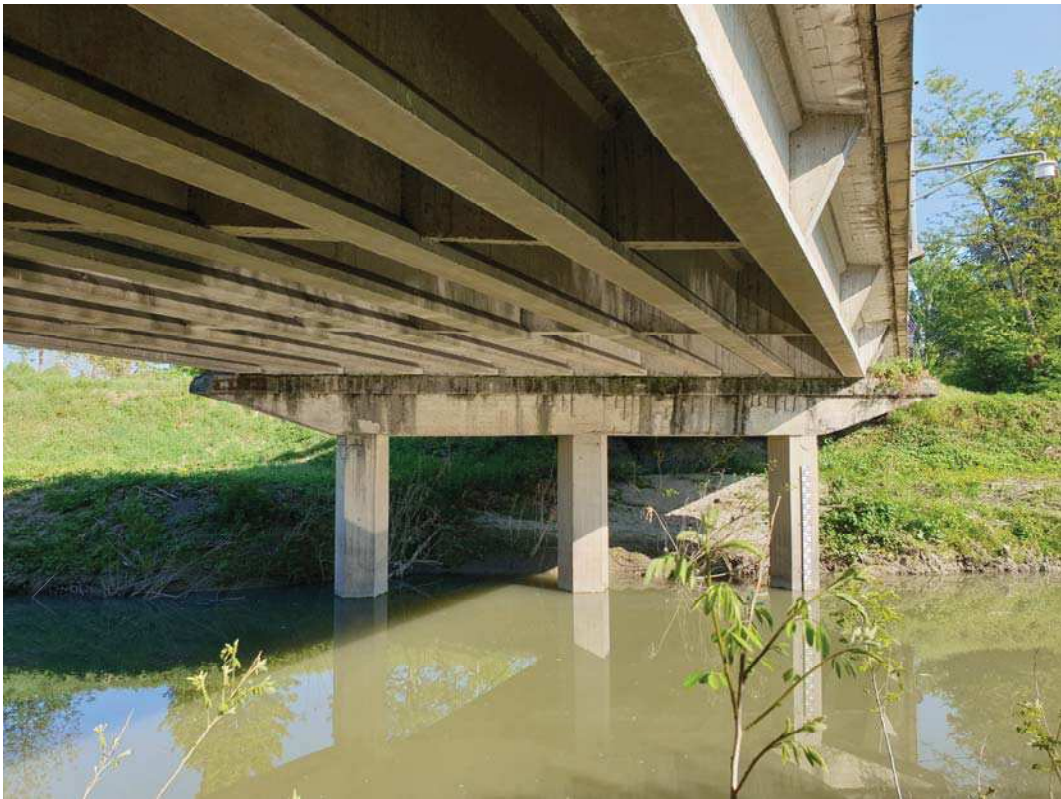
Foto 7 – Dettaglio del degrado della trave pulvino
