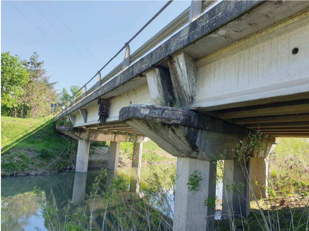
Foto 5 – Veduta generale dello stato di degrado di taluni elementi strutturali
