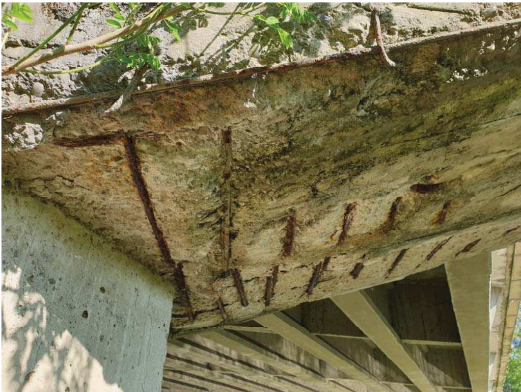
Foto 6 – Dettaglio del degrado della trave pulvino lato valle
