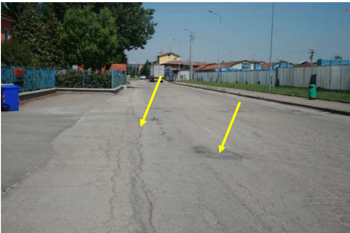
Vista da sud-ovest – fessurazioni, distacchi ed ammaloramento diffuso (limite intervento filo recinzione)
