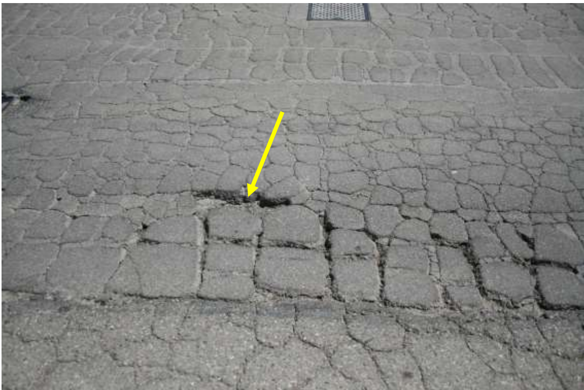
Dettaglio ammaloramento manto di usura che comporta infiltrazioni nella sottostante fondazione con cedimenti della stessa non correttamente dimensionata Elevato rischio per la sicurezza stradale
