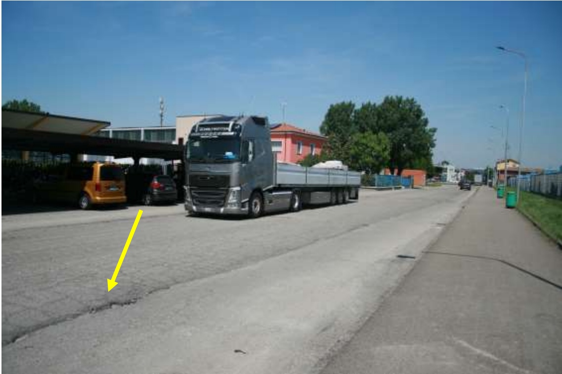
Vista da sud-est – fessurazioni, distacchi ed ammaloramento diffuso con cedimenti differenziali
