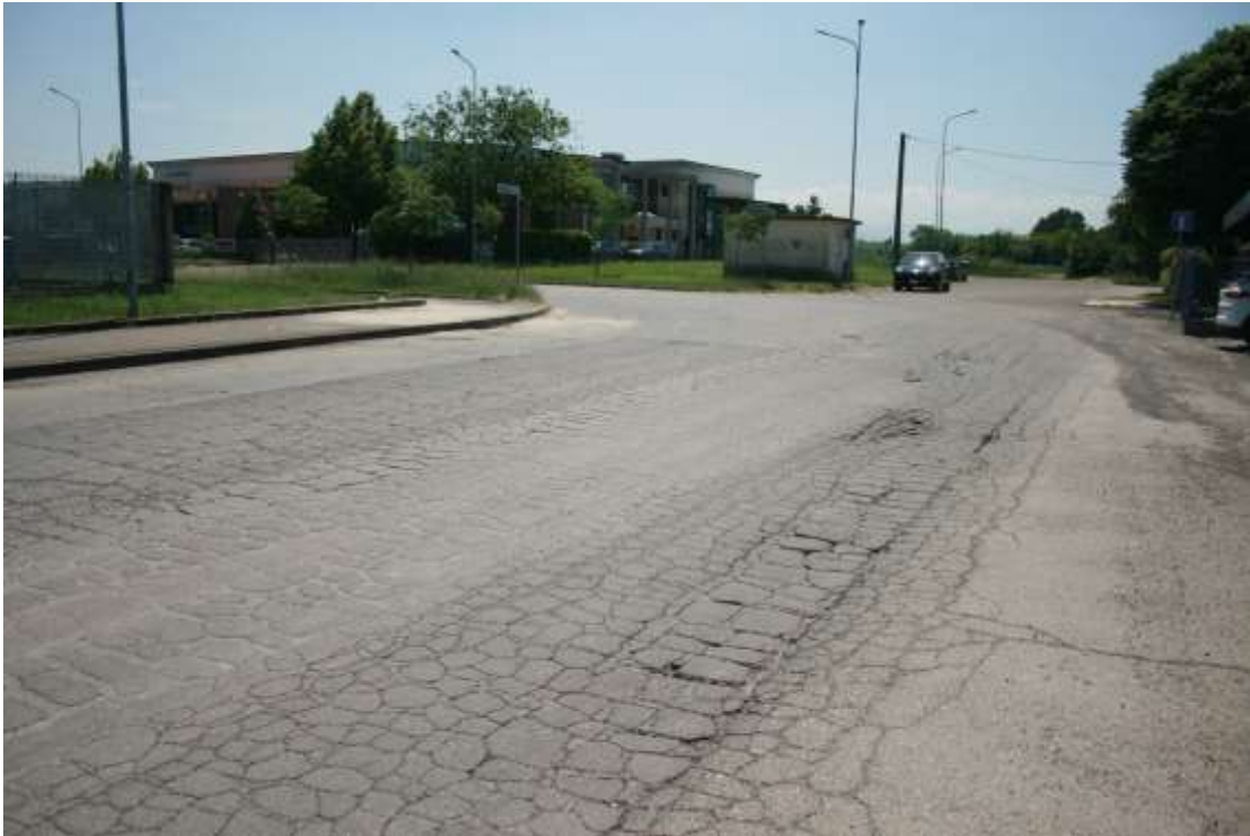
Vista verso via Falcone da ovest – cedimenti differenziali della pavimentazione con elevati rischi alla circolazione
