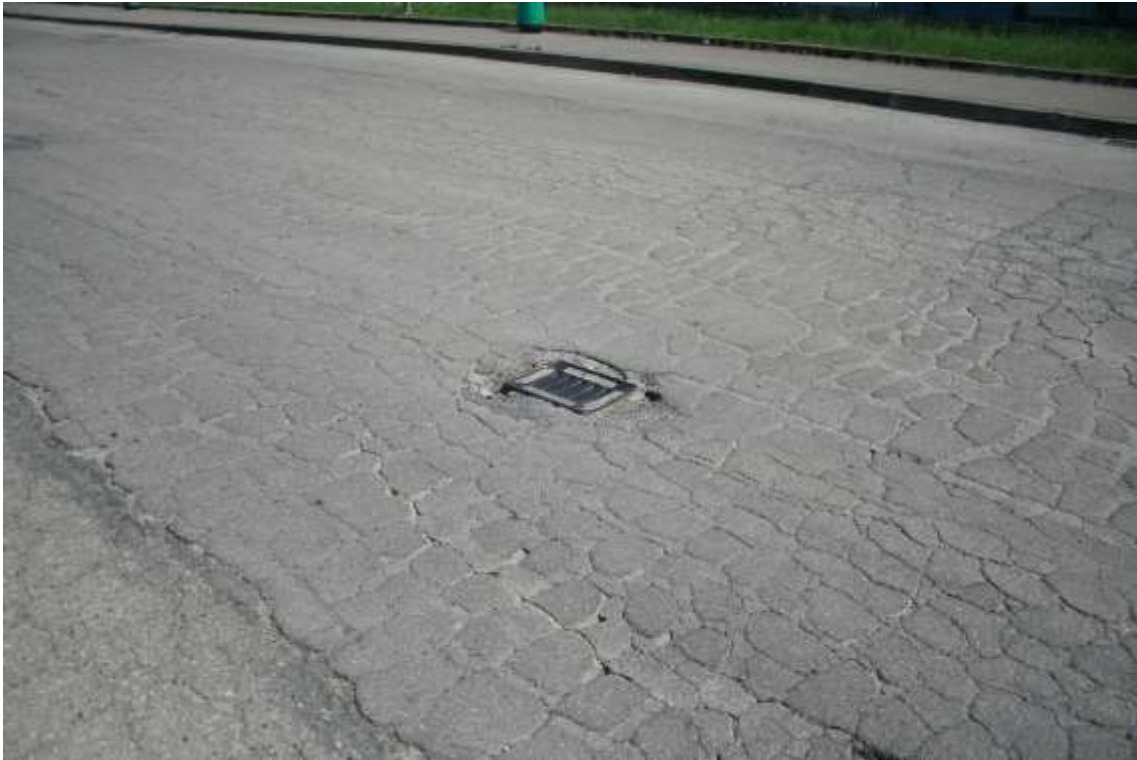
Dettaglio ammaloramento manto di usura con interessamento dell'impianto di raccolta acque superficiali
