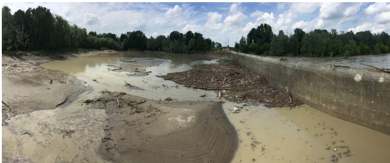
Fig. 3 materiale legnoso accumulatosi a monte del manufatto regolatore occludendone le due luci in sponda destra
