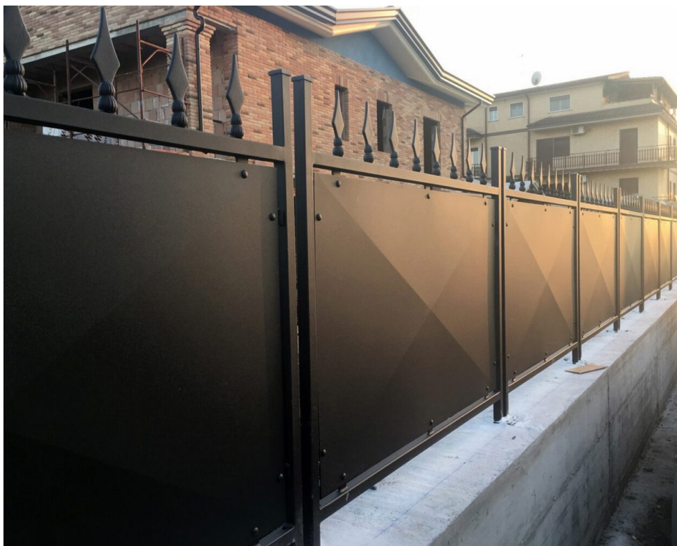
Esempio di pannellatura bugnata in ferro zincato e verniciata
