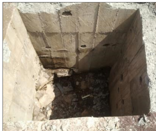
Figura 13: Un pozzo a perdere.
